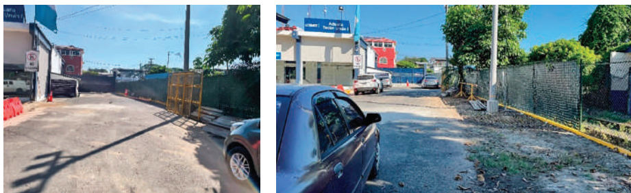
Mejora en áreas exteriores de la Aduana Tecún Umán I, instalación de malla con cintas de polietileno, trabajos de reparación de malla en perímetro de la Aduana, reparación y mejoramiento de drenajes pluviales en áreas de parqueo.
